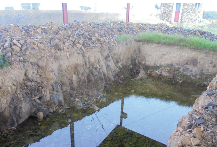
Etang en construction à Herdade das Cebolas, Campinho, Portugal. (Janeiro, 2018). Joana Paulo
